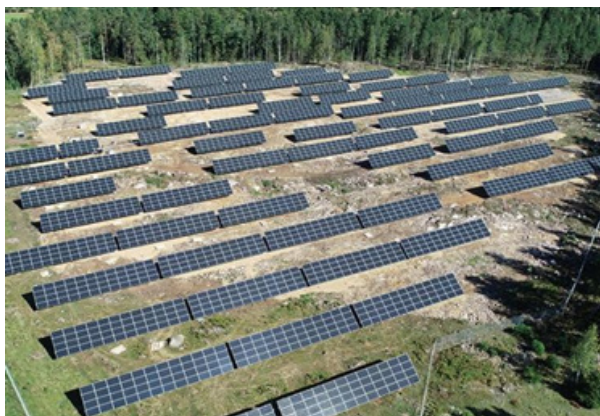
Bredstorps andelsägda solcellspark
